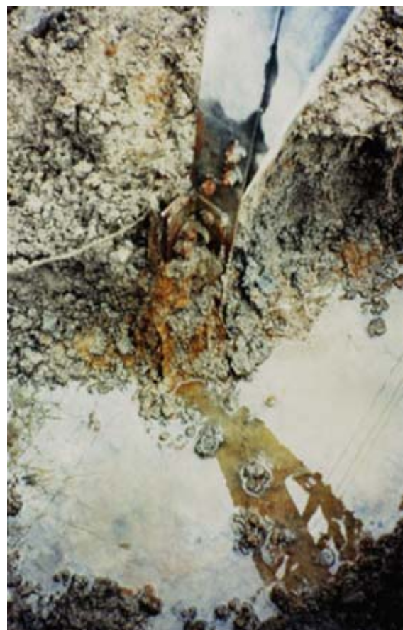
Figura 3. Corrosão na Base da Torre Metálica [3].
