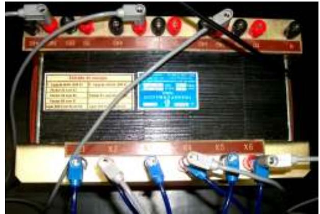
Figura 18 - Imagem da conexão D-Y (Delta-Estrela) no transformador alimentado com 220 V.
